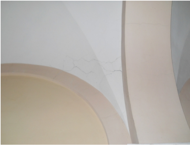
27. Nastere arc parter, fisurata
