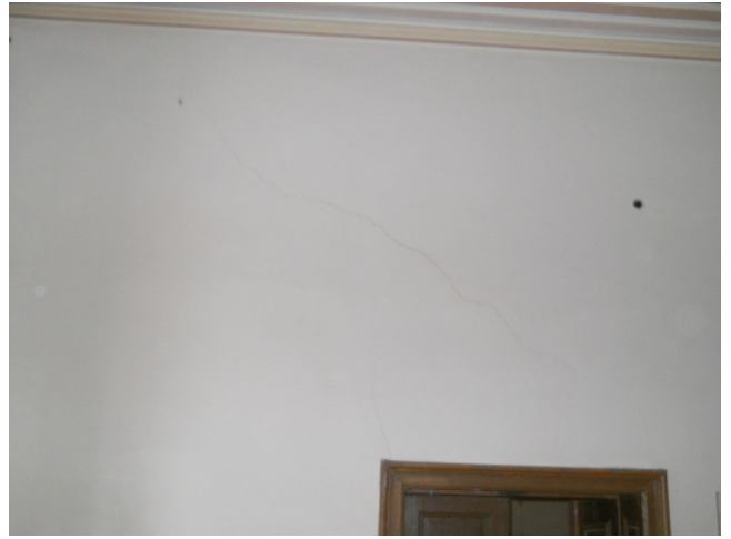
77. Buiandrug usă fisurat oblic
