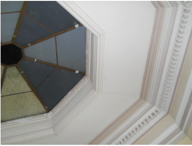
53. Planseu octogon peste scarile secundare fisurat
