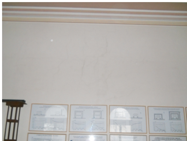
71. Fisuri verticale, spaleți plini lungi
