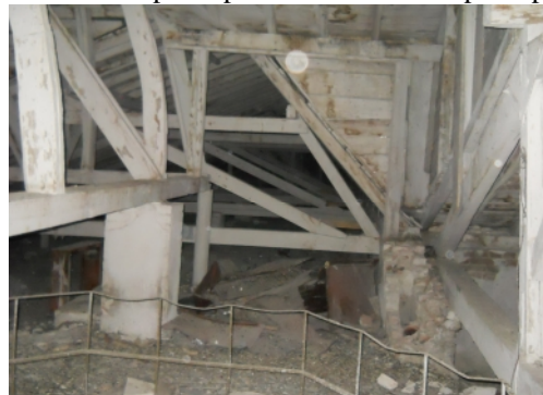
46. Șarpantă cu elemente degradate, atacate de microorganisme
