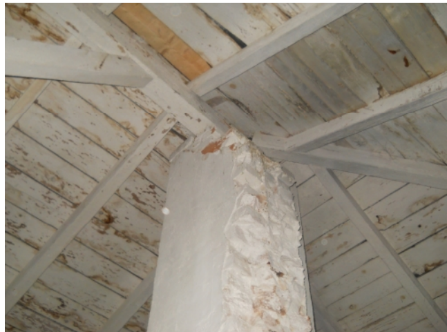
36. Calcan zidarie zona holului central
