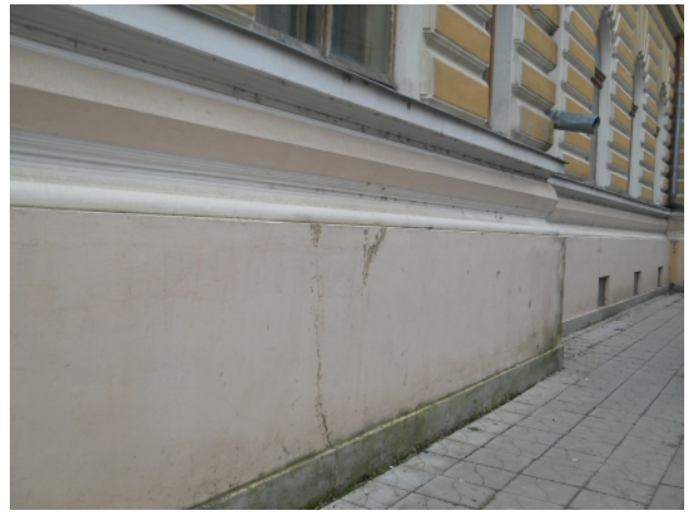
26. Parapeti zidarie fisurati
