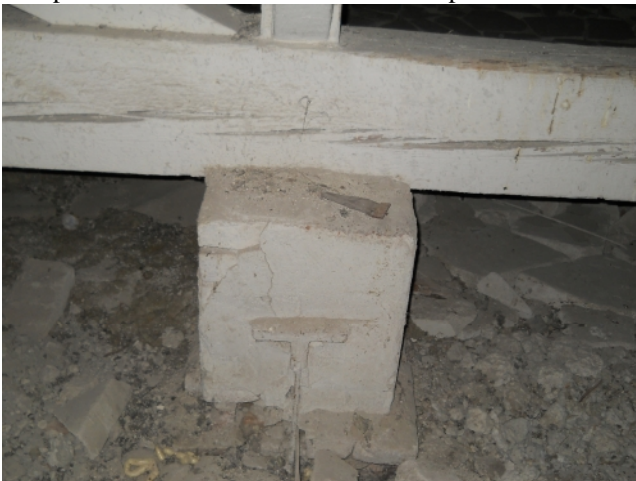
35. Talpi fermă lemn fisurate, fără ancoraje
