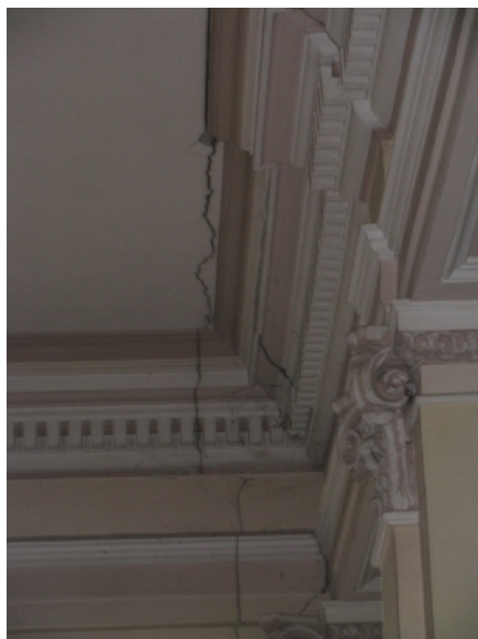
Foto 15 –Tavan peste casa scărilor - fracturi
