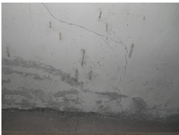
70. Fisuri inclinate parapeti demisol
