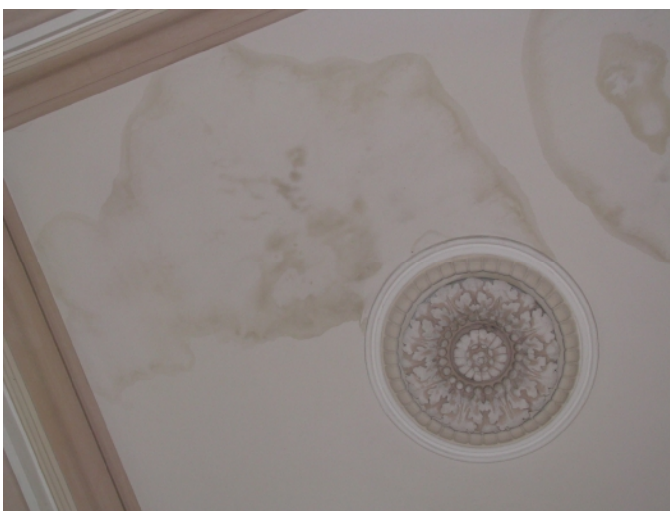
Foto 17 – Infiltratii in tavan peste etaj
