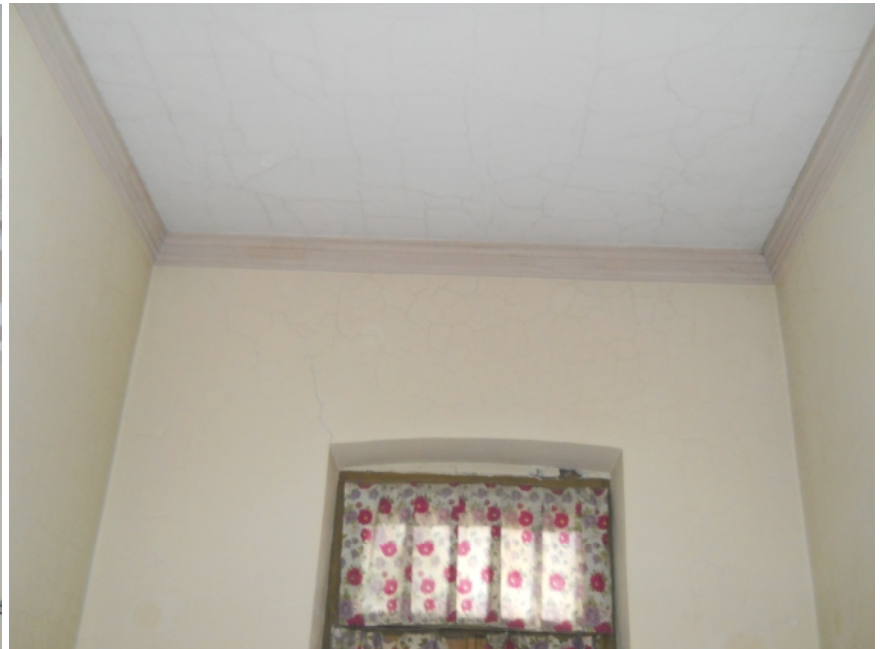
56. Buiandrugii in boltă ferestre, tencuiala tavan fisurate
