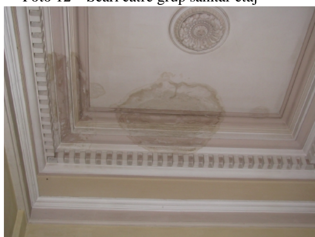
Foto 14 – Idem – infiltratii prin acoperis
