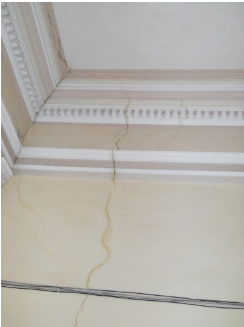
55. Fisură perete zidărie etaj, zona octogon
