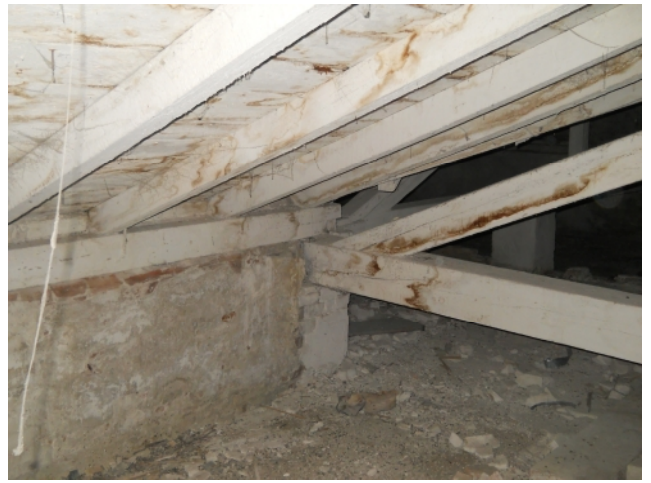
48. Șarpantă cu elemente degradate, atacate de microorganisme
