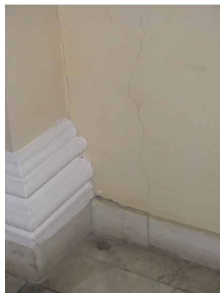
Foto 16 – Pardoseală marmoră, fisuri pereti
