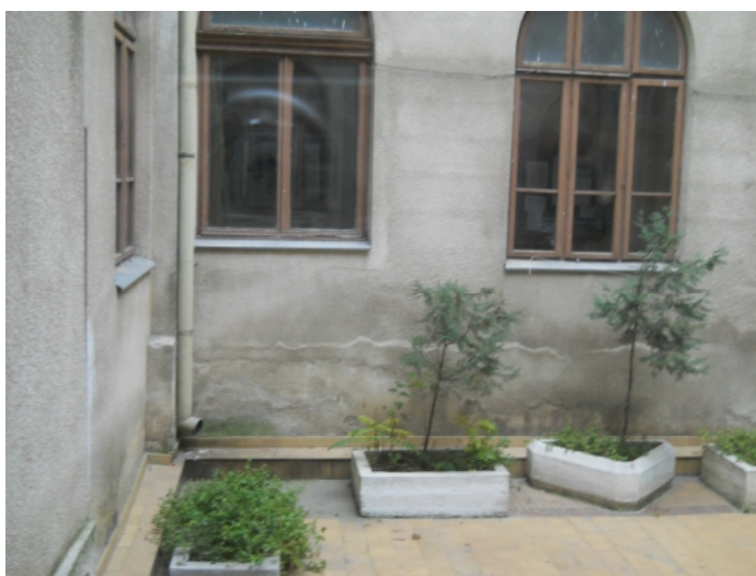
78. Curte interioara, igrasie parapeti
