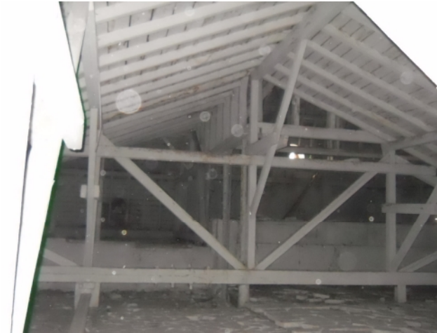
33. Sarpanta lemn subdimensionata zona aripiei Libertatii
