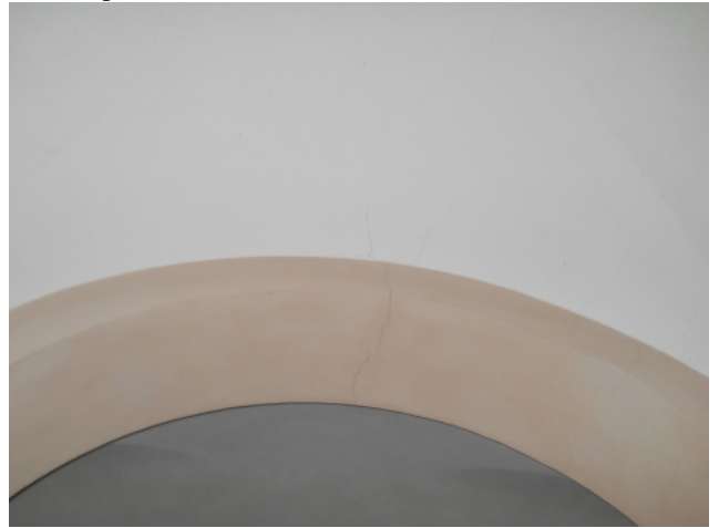
28. Cheie bolta parter fisurata
